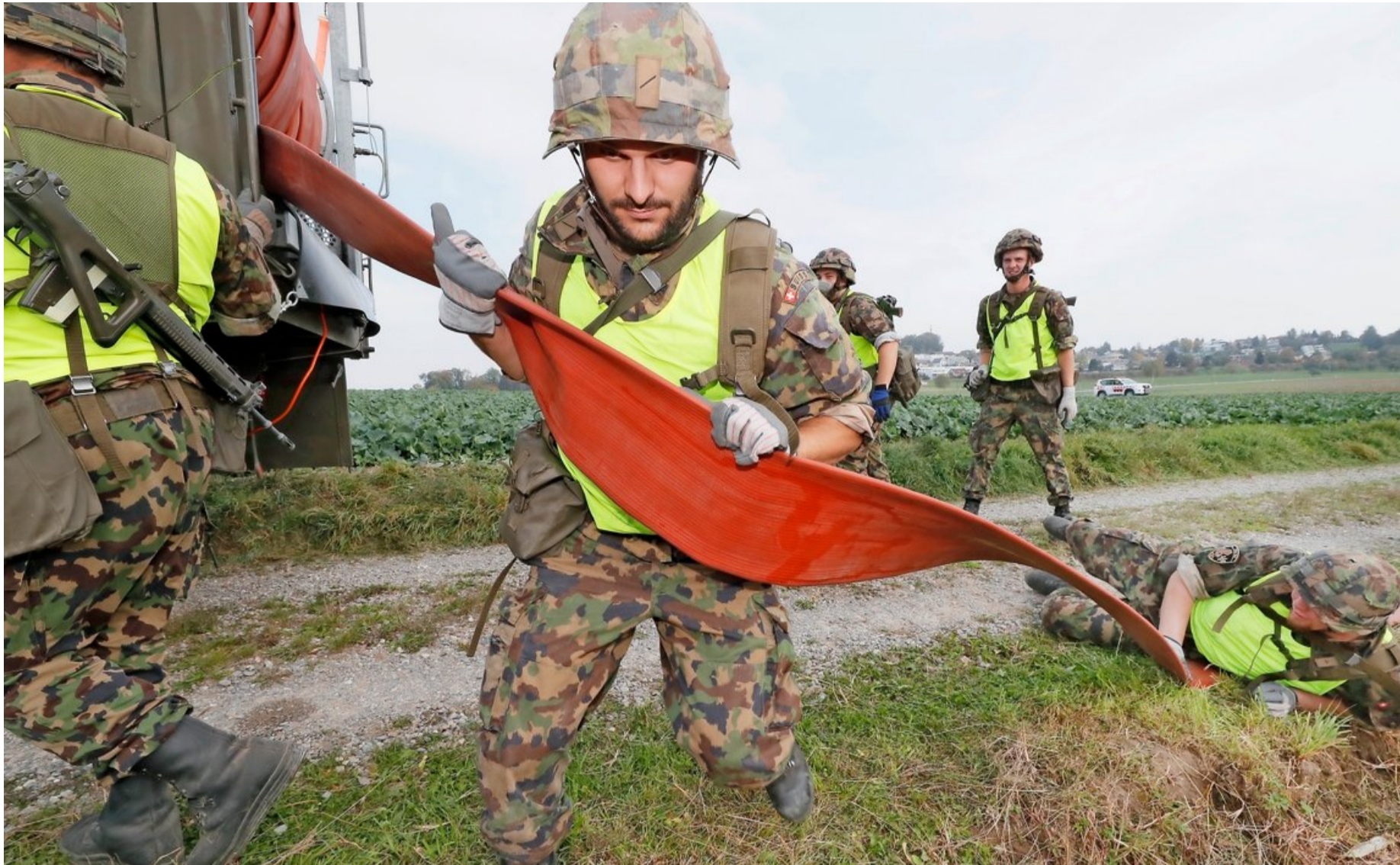
Das Verlegen der Wasserschläuche über zwei Kilometer erforderte von den Militärangehörigen vollen Körpereinsatz.
